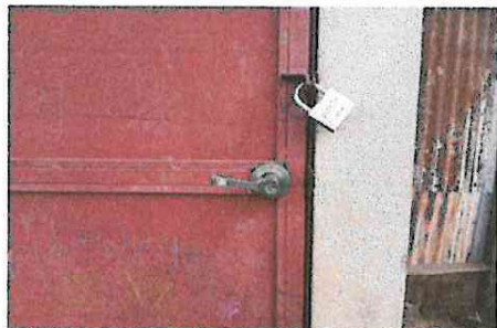
Foto 1: Chapa en mal estado
